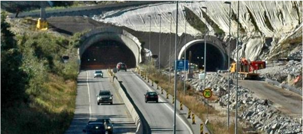
Figur 7-25: Eksempel på tunnelbygging. Nytt løp satt i drift med toveis trafikk mens eksisterende tunnel opprustes
