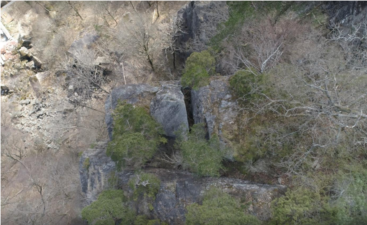
Figur 62: Overside påhugg, tatt vertikalt nedover. Viser avløste blokker.
