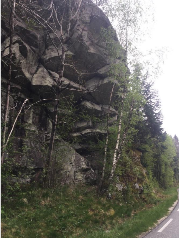
Figur 31: Bilde tatt nord i påvirkningsområdet, mot SØ. Viser overhengende blokker.
