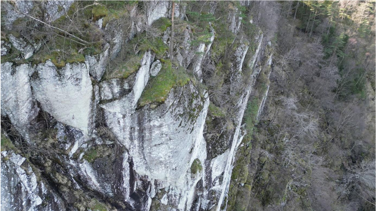
Figur 49: Steil bergside på oversiden av påhugget. Samme som i Figur 47, sett ovenfra. Avløst parti uten fot i underkant vist i midten av bilde.
