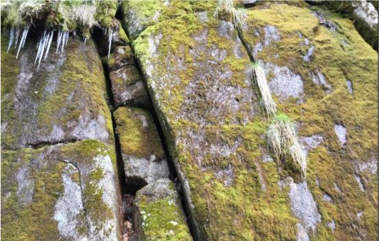
Figur 40 Bergmassen i området har stedvis åpne sprekker og avløste blokker. Bergoverflaten på bildet følger sprekkesett 2 mens de steile sprekkene er sprekkesett 1. Bildet er tatt mot NØ.
