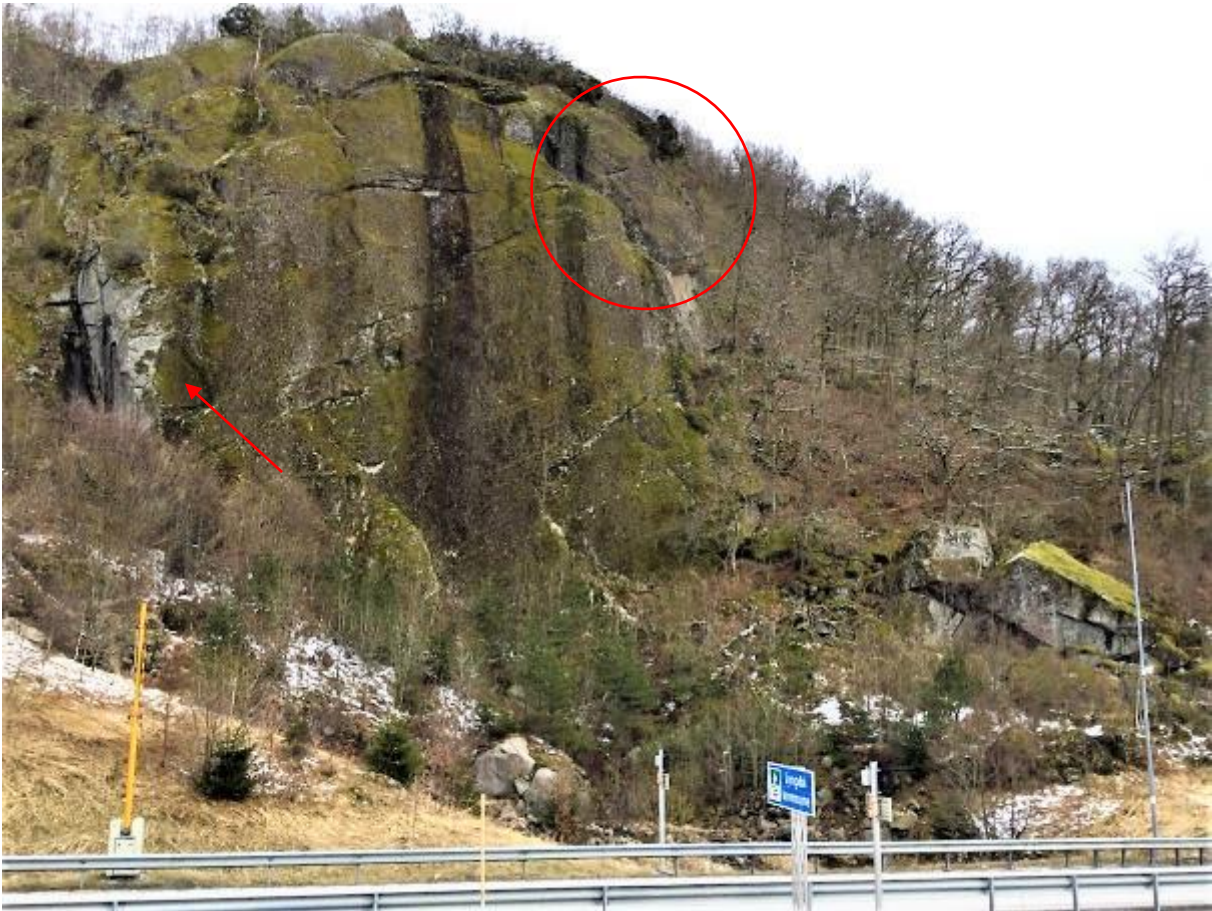
Figur 42 Oversikt over bergskrent. Parti med avløste blokker er merket med rød sirkel. Baksprekk er kartlagt omtrent ved rød pil. Bildet er tatt mot ØNØ.
