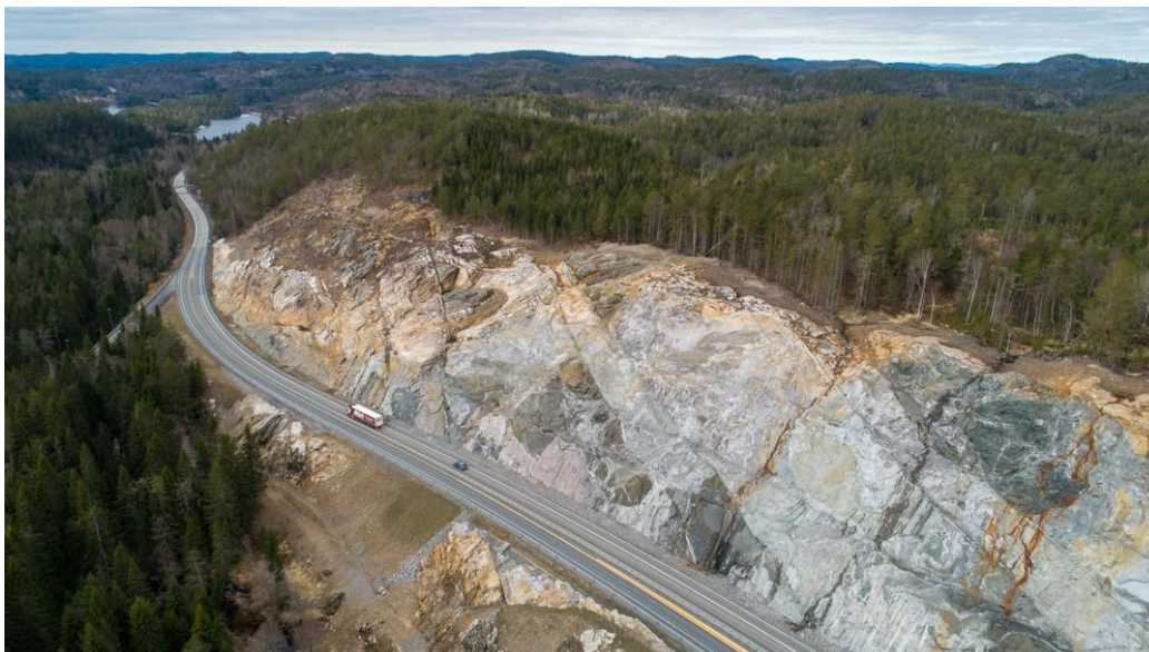
Fjellskjæring ved Dørdal, bak ligger Bakkevann (Bamble) og Hullvann (Kragerø) Foto: Dronefoto: Per-Kåre Sandbakk / NRK
